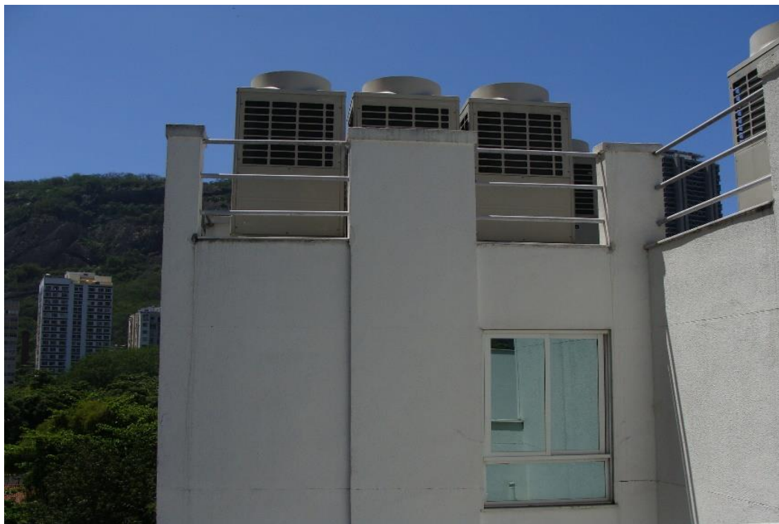
Fotografia n° 22 - Visão externa do sistema de ar condicionado central da edificação
