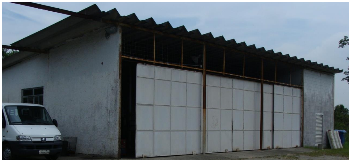
Fotografia nº 53 - Retratação das condições de um dos prédios do complexo.
