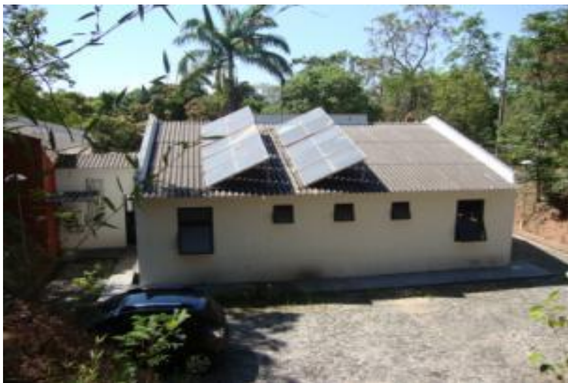
Fotografia n° 08 - Coletor solar do laboratório de trítio.
