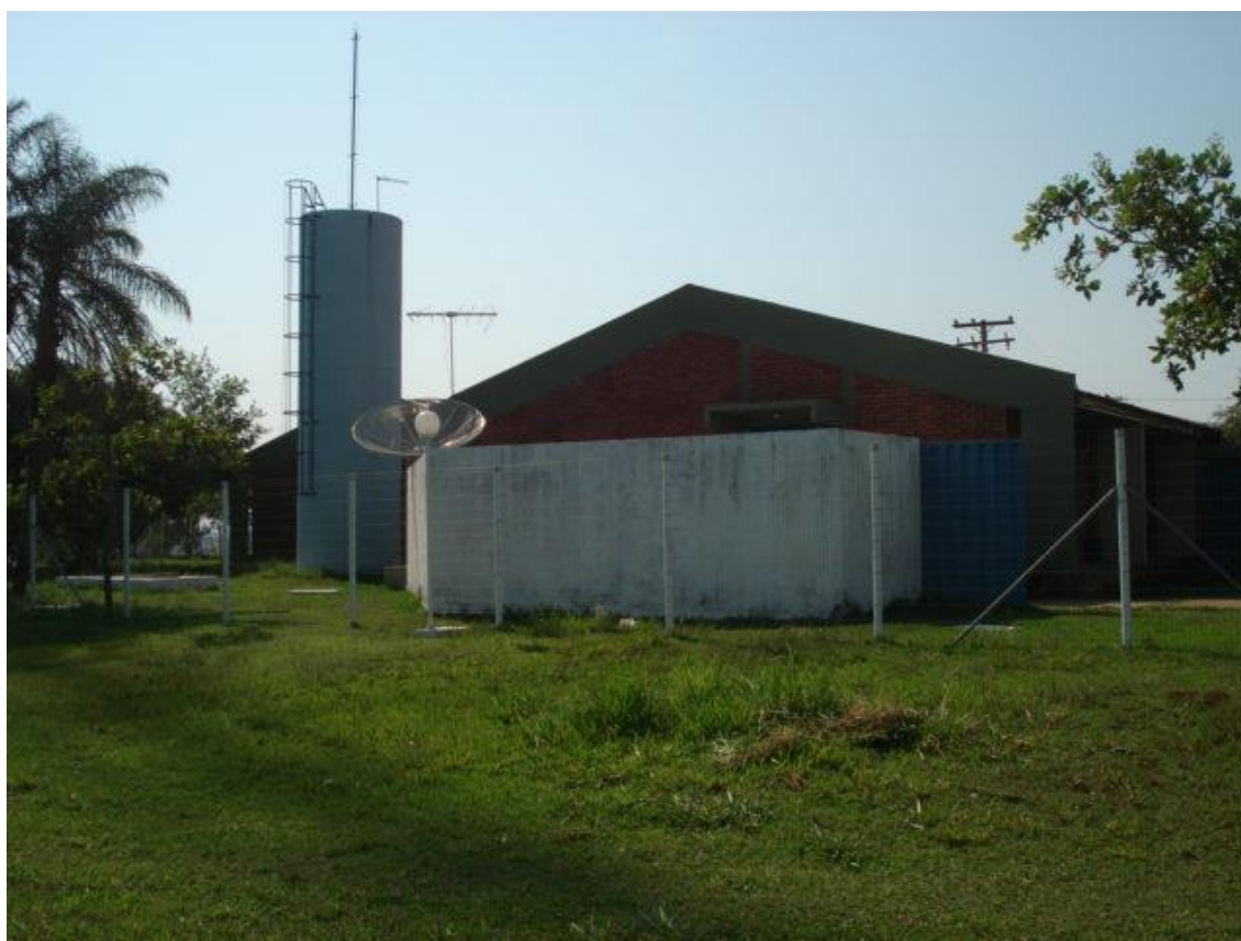
Fotografia nº 26 - Caixa de água de sistema hidráulico na época de construção das edificações
