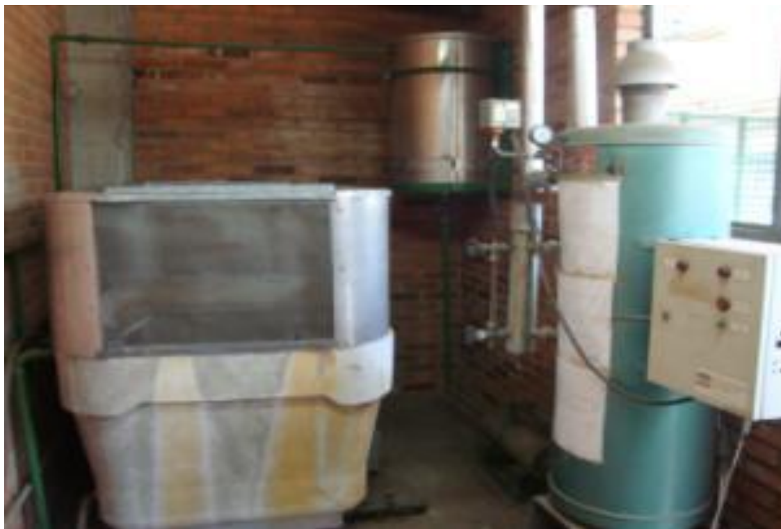
Fotografia n° 04 - Processo de recirculação de água de refrigeração de equipamentos
