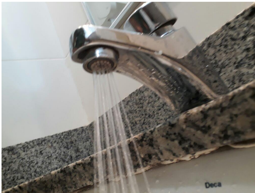
Fotografia nº 15 - Sistema de torneiras com temporizadores.
