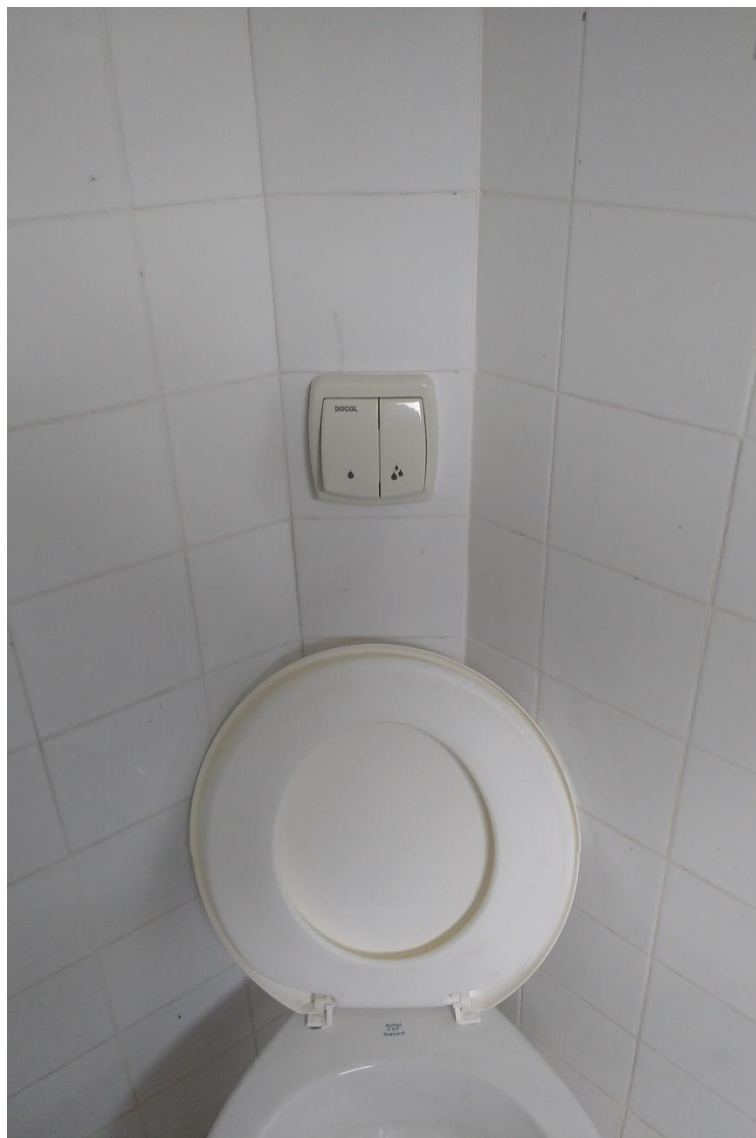
Fotografia n° 43 - Bacias sanitárias e descargas com controle de volume de água.
