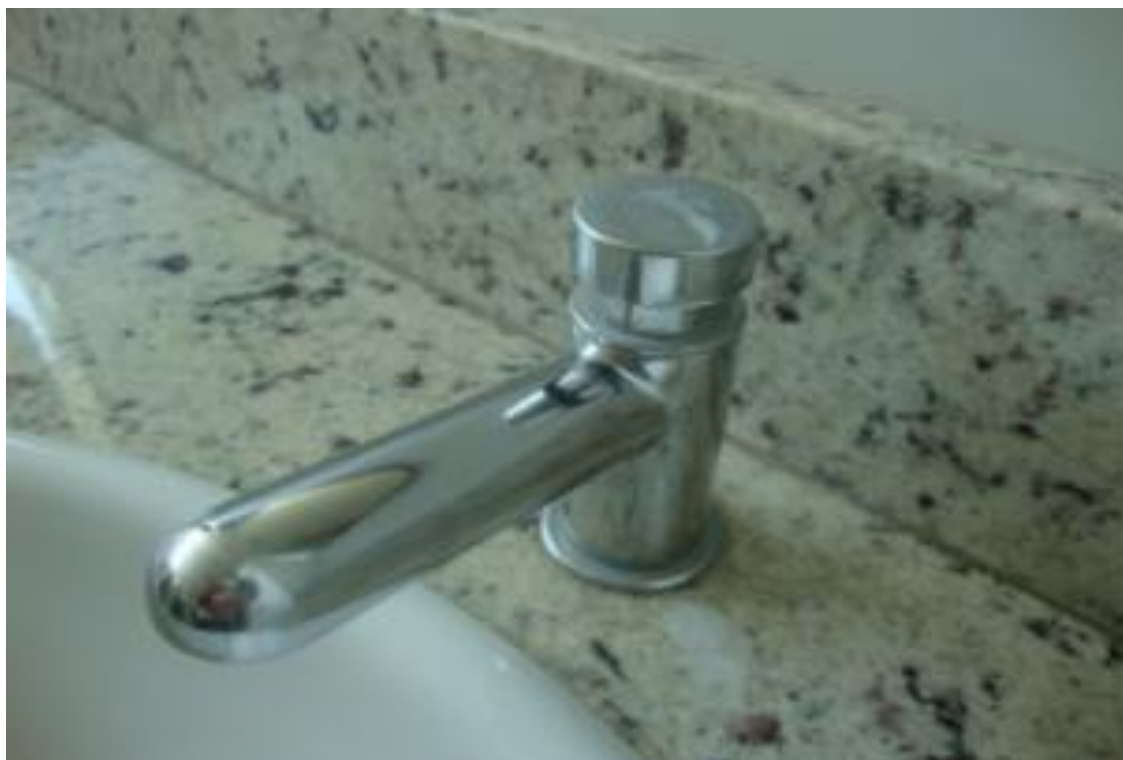
Fotografia nº 02 - Torneira com temporizador para redução de desperdício
