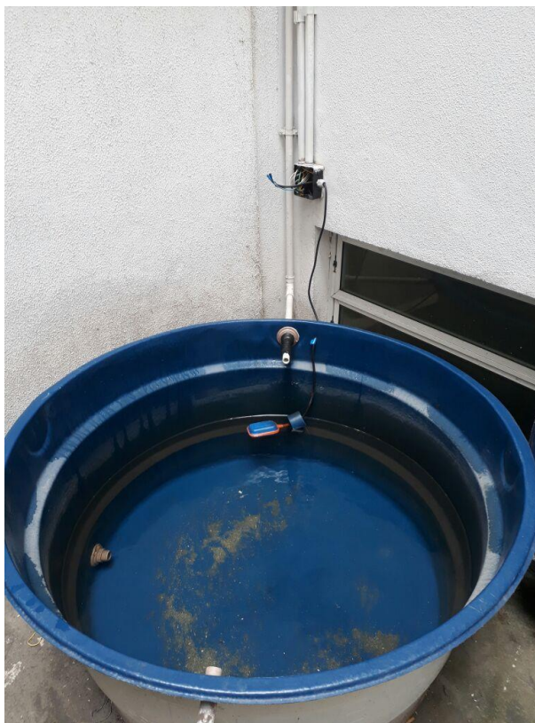
Fotografia nº 18 - Reservatório do sistema de captação de águas pluviais
