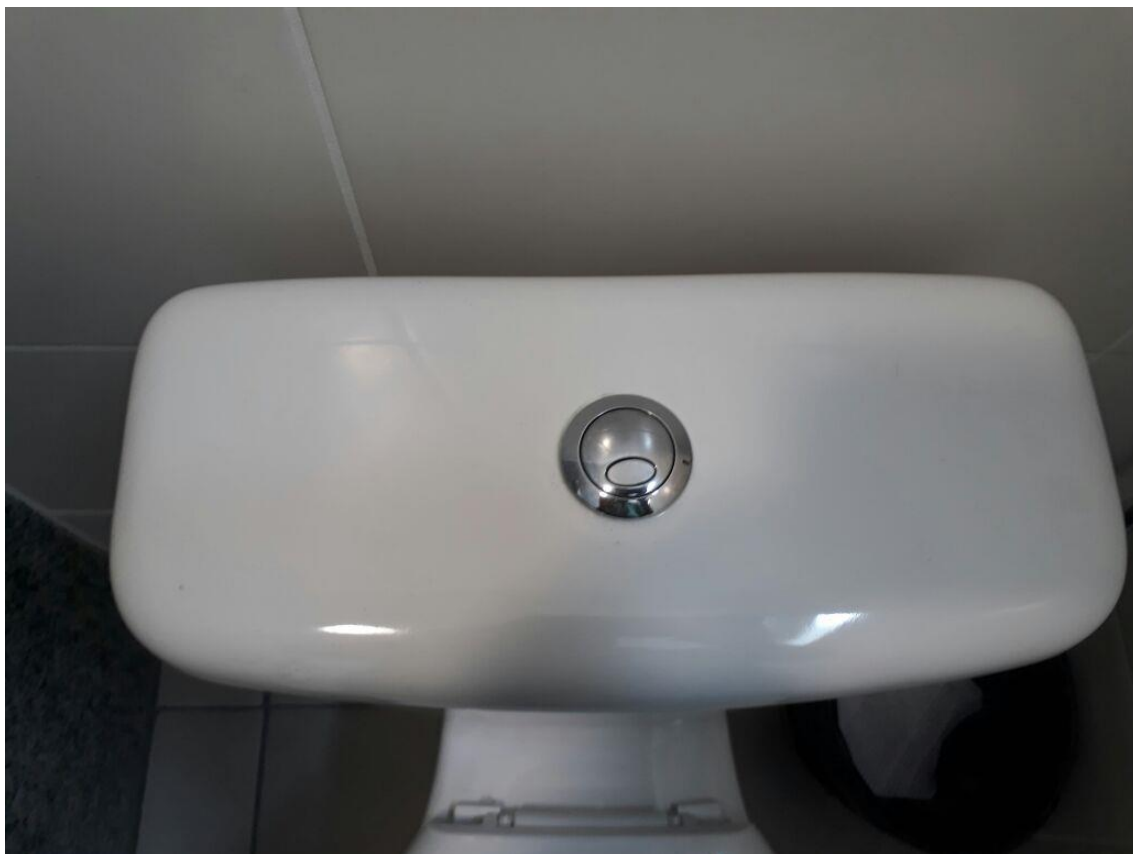
Fotografia nº16 - Descarga com acionamento duplo – prédio 2
