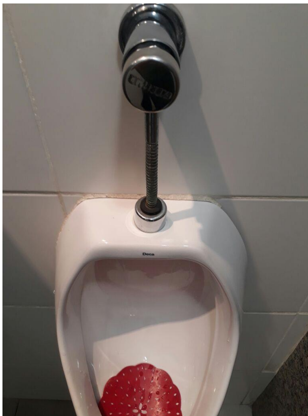
Fotografia n° 17 - Válvula temporizadora para mictório
