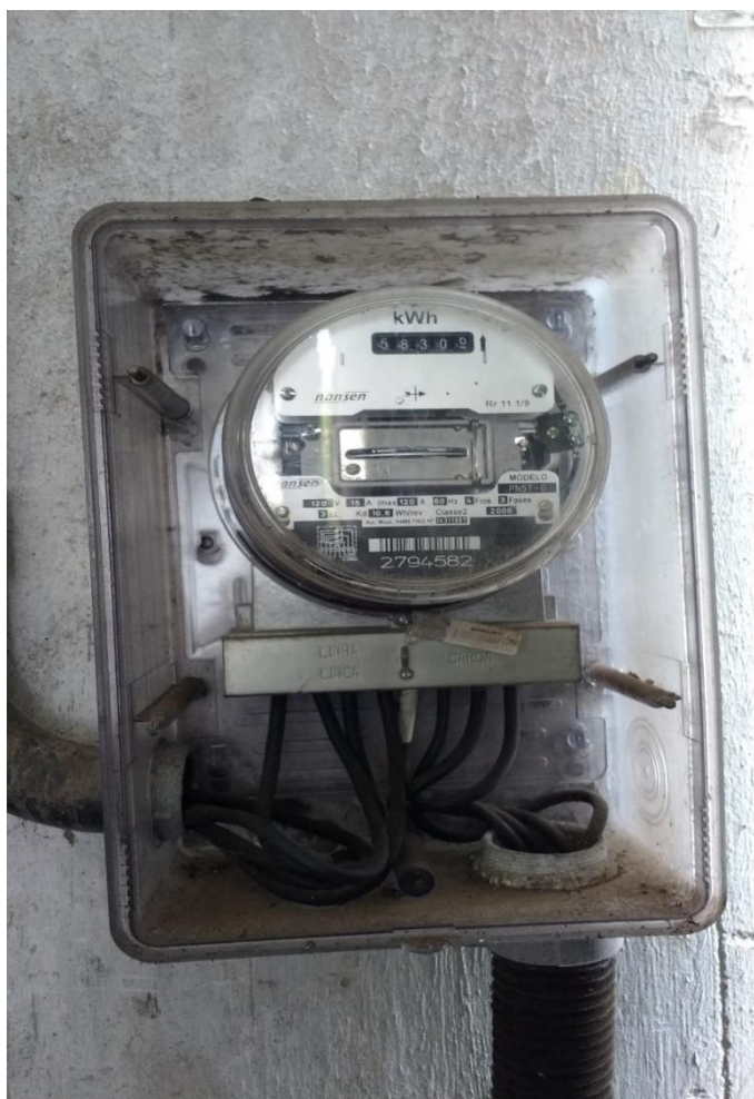
Fotografia nº 51 - Sistema de medição de controle de consumo de energia elétrica.
