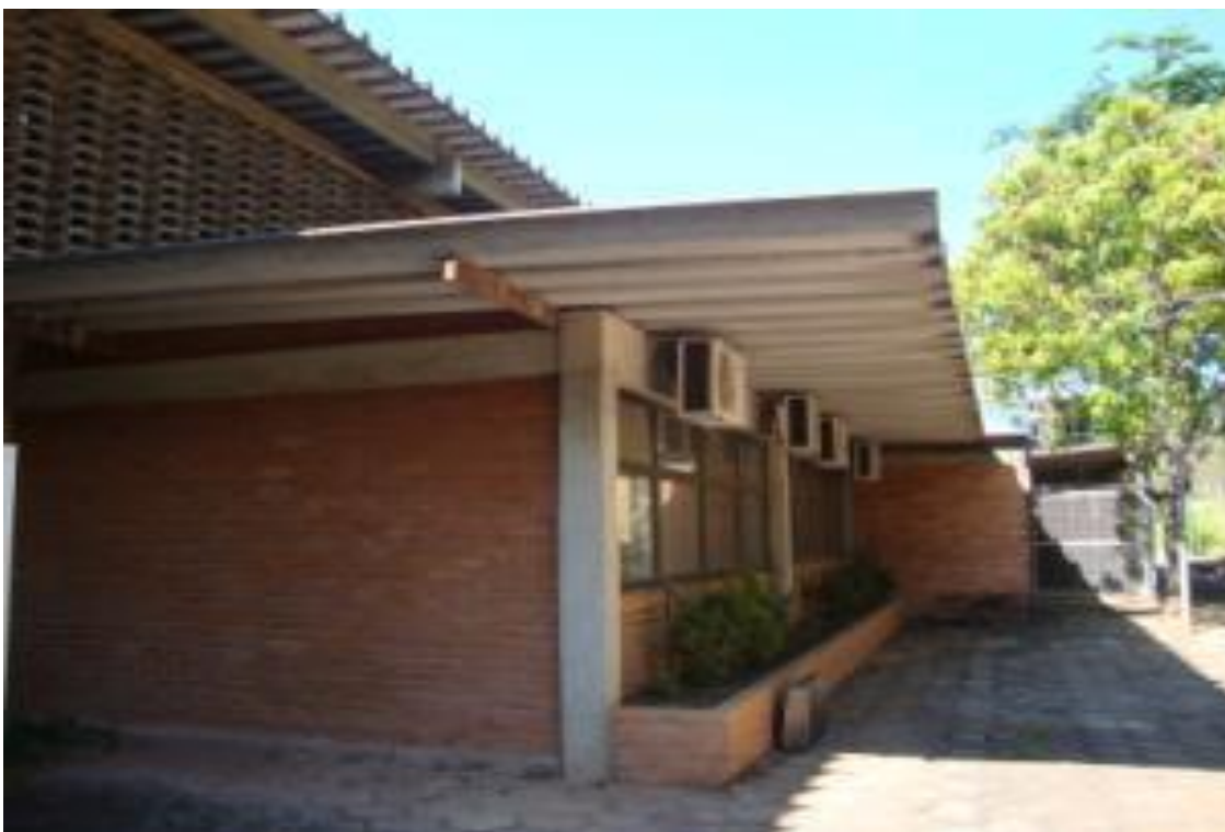
Fotografia nº 09 - Condicionador de ar com maior eficiência energética – visão externa.
