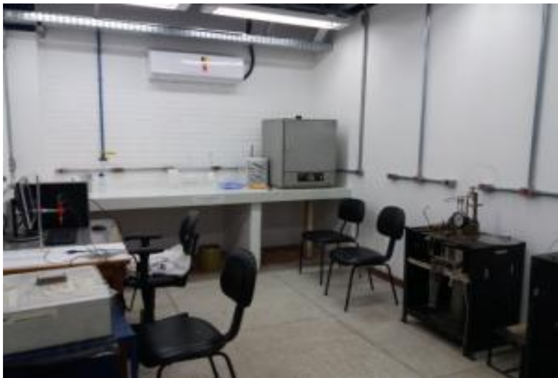
Fotografia n° 10 - Condicionador de ar com maior eficiência energética – visão interna.
