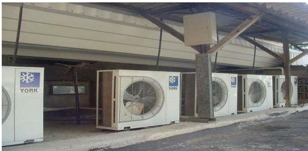
Fotografia nº 63 - Condicionadores de ar com maior eficiência energética.
