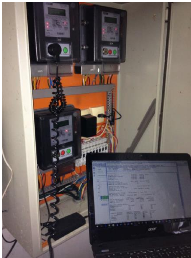
Fotografia n° 65 - Monitoramento do consumo de energia de uma das edificações.
