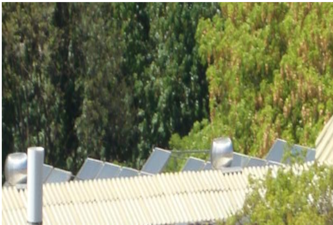
Fotografia n° 07 - Coletores de energia solar para restaurantes e banheiros.
