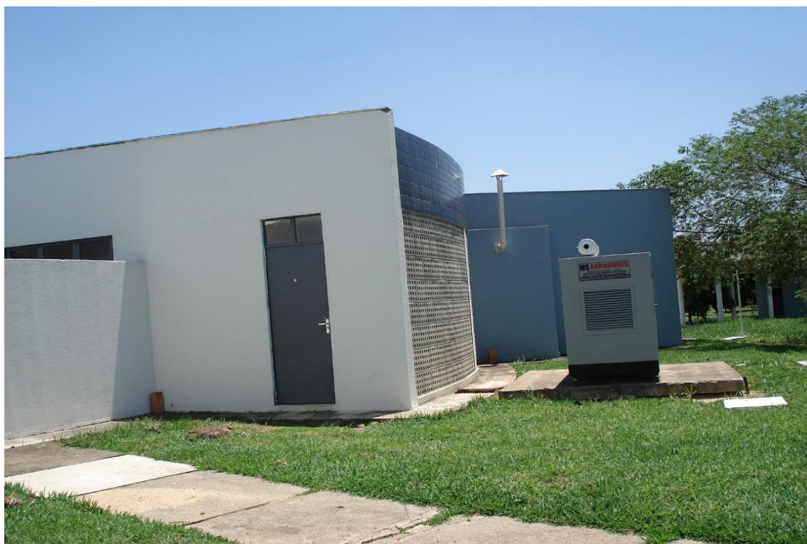
Fotografia nº 32 - Um dos geradores de emergência para atender a edificação.
