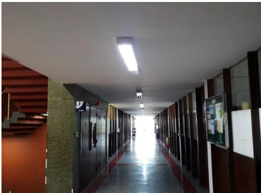
Fotografia nº 64 - Edificação com luminária LED 18W instalada nos corredores.
