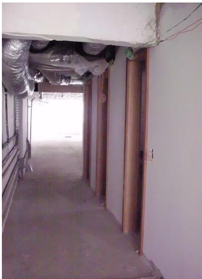
Fotografia nº 21 - Visão interna do sistema de ar condicionado central da edificação
