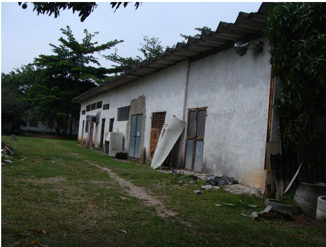
Fotografia nº 40 - Edificação com cobertura com material considerados inadequados ao meio ambiente.
