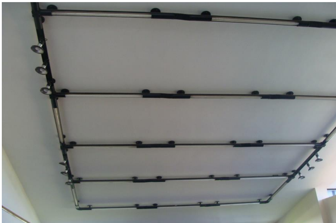
Fotografia n° 30 - Lâmpadas com mais eficiência energética instaladas.
